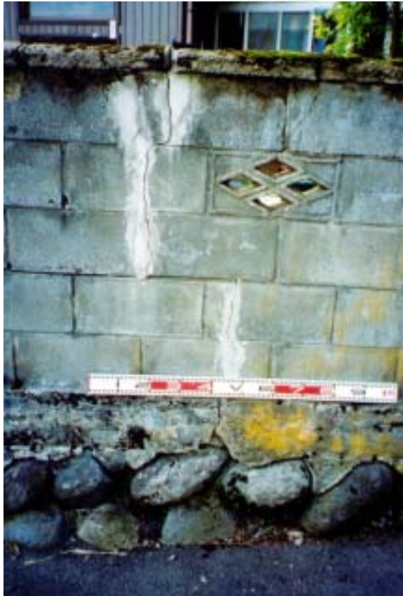
ブロック塀での亀裂発生状況
